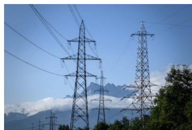
Réseau de lignes à haute tension dans les Pyrénées. © Fabrice Coffrini/ AFP
